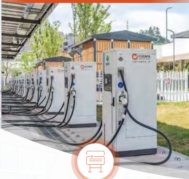
安吉鞍山站光储充换一体化工程
